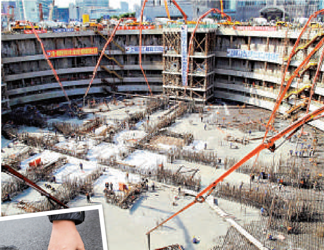
▲肇事「元兇」上海中心地基建工程 楊楠攝
