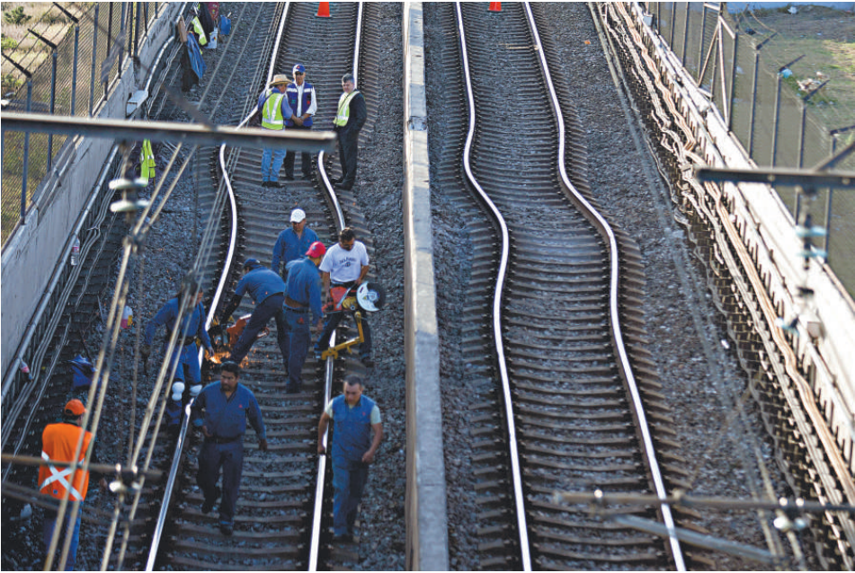
▲工人們正在修理因地震而扭曲變形的軌道
