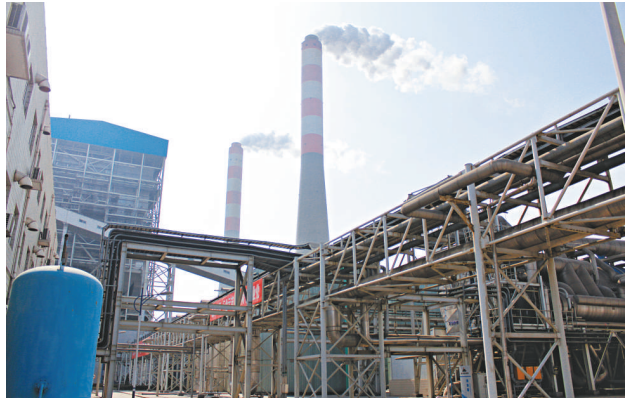
▲神華河北國華滄東發電有限公司海水淡化設備 本報攝
