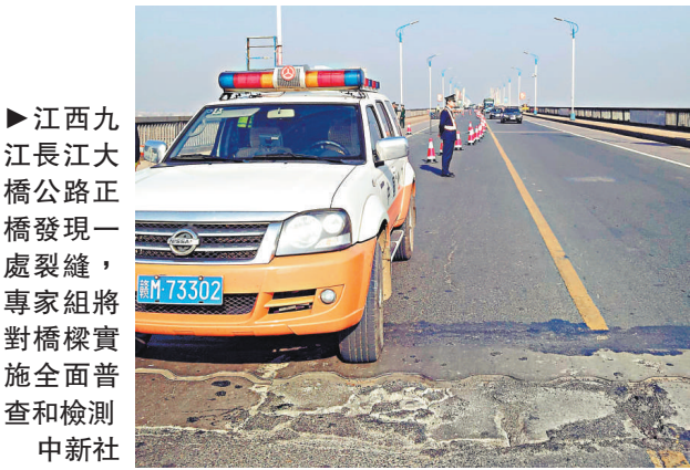
►江西九江長江大橋公路正橋發現一處裂縫，專家組將對橋樑實施全面普查和檢測 中新社
