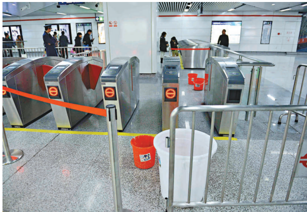
▲杭州地鐵開通不到10日已發生3次漏水情況 中新社
