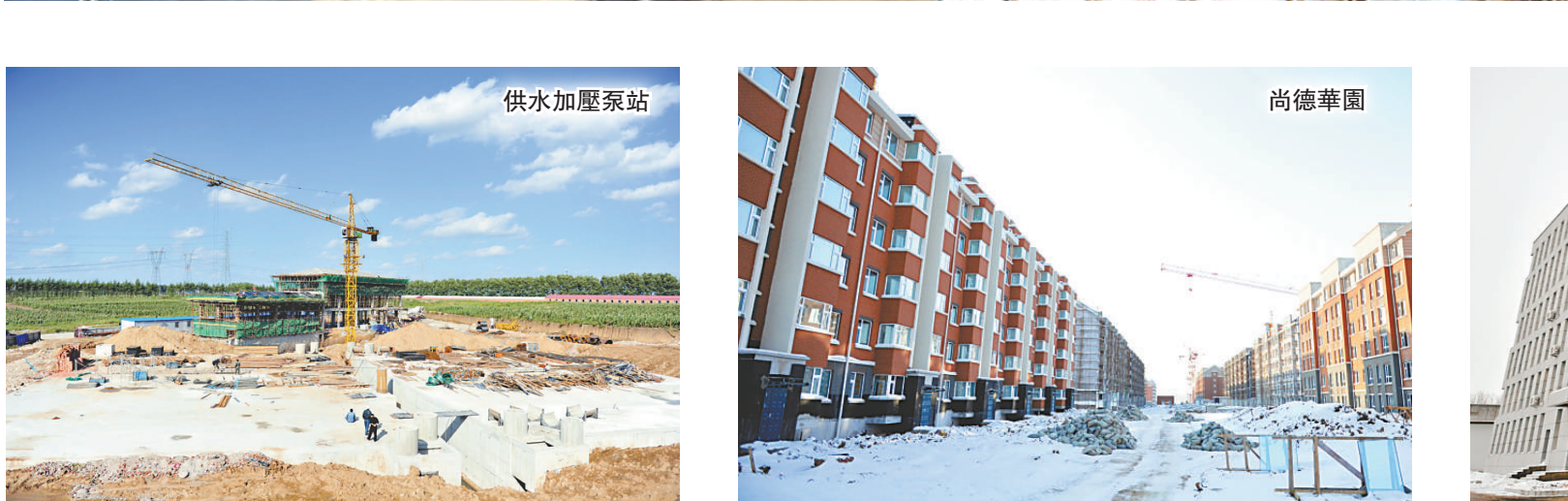
供水加壓泵站 尚德華園
