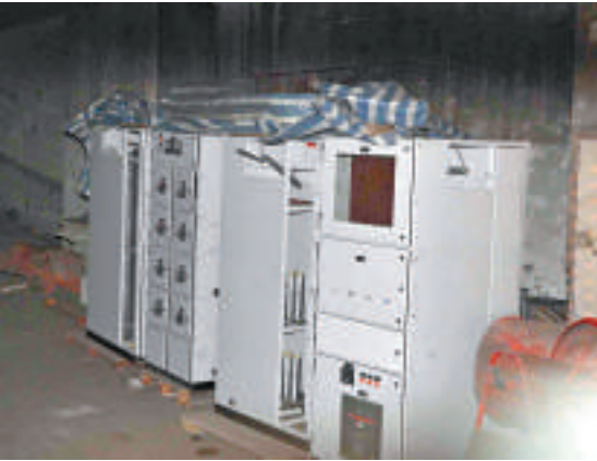
▲部分被盜去銅片的電掣箱
