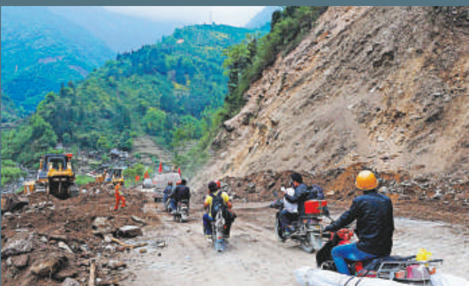
▲蘆山屬地質災害多發地區，地震造成山體破裂，加上餘震頻發，一旦連續下雨，極易發生嚴重次生地質災害 新華社
