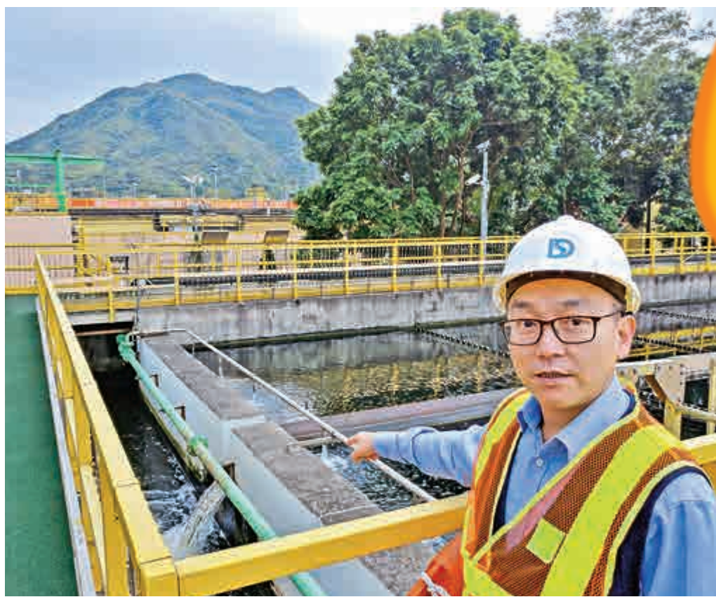
▲渠務署高級機電工程師唐遠峯稱，曝氣池已將污水淨化九成
