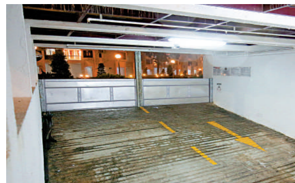
▲以往發生過水浸的地下停車場，門口已加裝水閘擋水。大公報記者麥潤田攝
