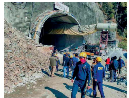
▲印度北部一條隧道發生坍塌，造成40名工人被困。網絡圖片
