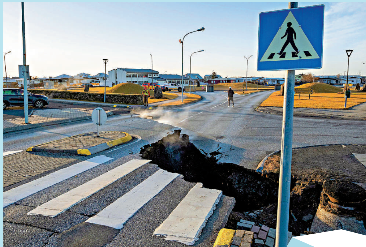
▲冰島格林達維克鎮馬路上13日出現巨大裂縫。
