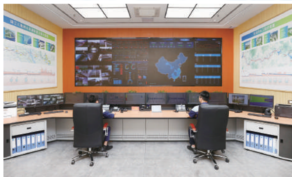
▲東深供水工程實行24小時智能調度，圖為粵港供水總調度中心。
